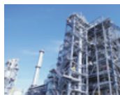
バケットエレベーター・フローコンベヤ
